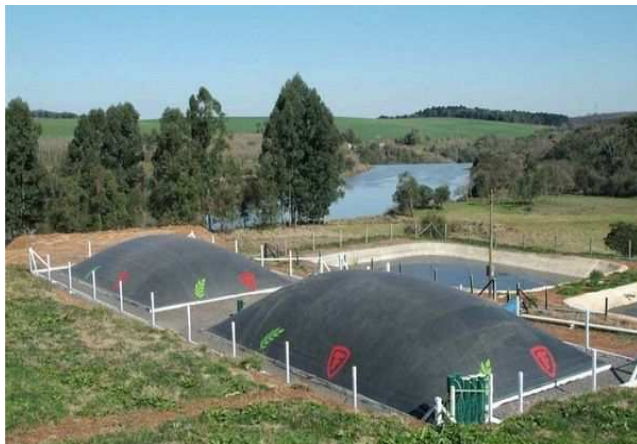
Biodigestores en agroindustria
