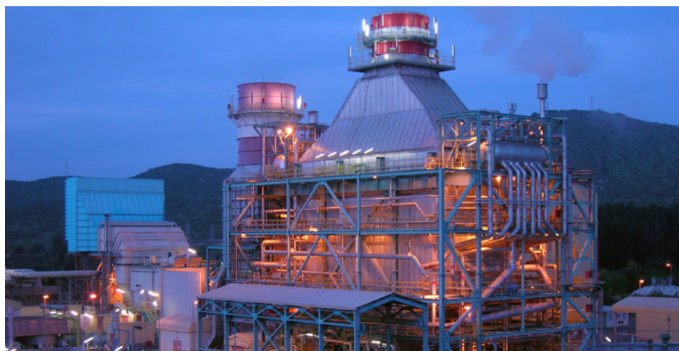
Central termoeléctrica de ciclo combinado ubicada en Quillota
